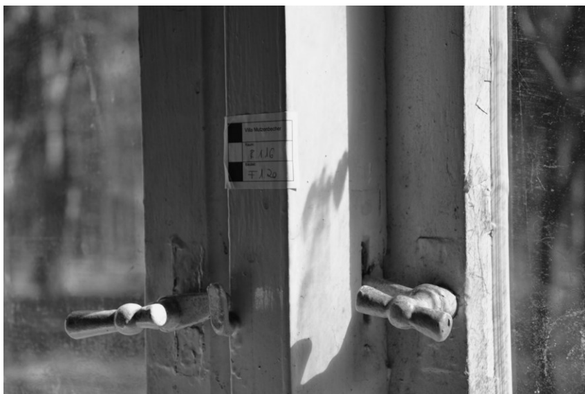
Abb. 4: Bestandsaufnahme Fenster (Foto: Andreas Zopff)
