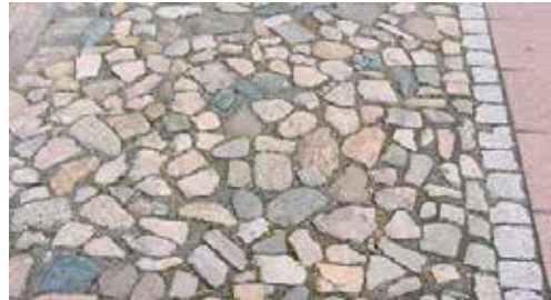
Kiesel-Wackelpflaster außerhalb eines Gehweges
